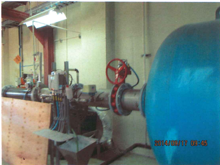
Photo 3. Usine de traitement des eaux
