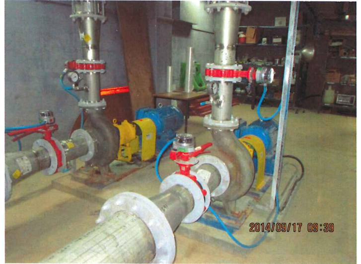
Photo 2. Usine de traitement des eaux
