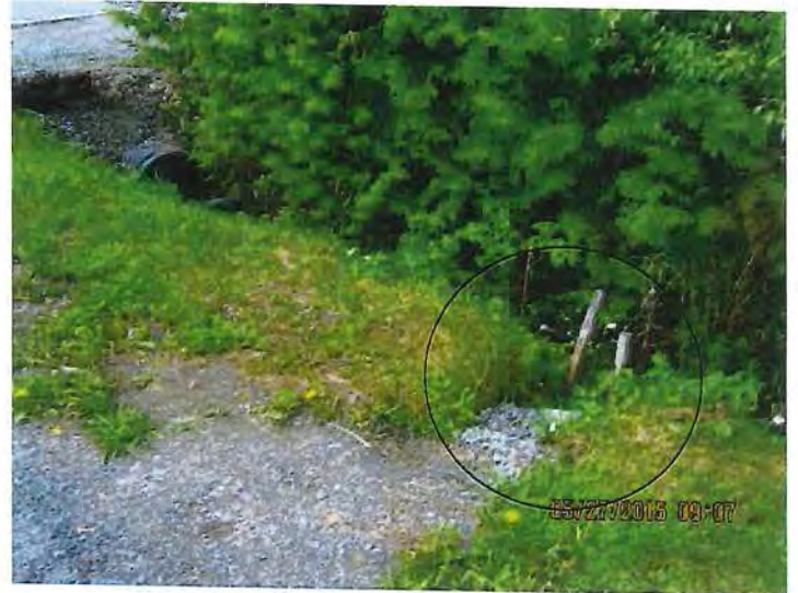
4. Un trou a été creusé et rempli de pierres concassées pour faciliter l'écoulement de l'eau du stationnement vers le cours d'eau (IMG_0543.jpg).
