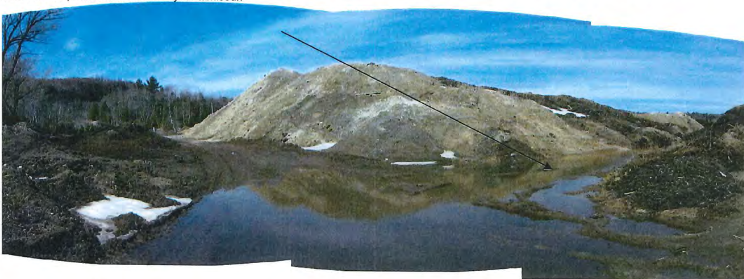
Vue d'une portion du mur antibruit aménagé avec des résidus chaulant sur une longueur approximative de 300m et une hauteur bien supérieure à 6.5m. La flèche indique la brèche.
