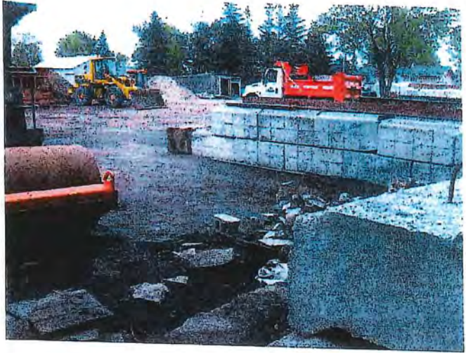
5. Des matériaux entreposés dans la bande de protection riveraine.
