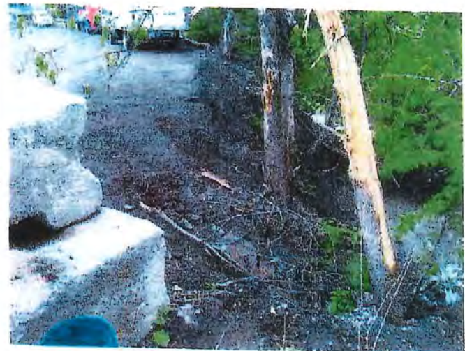
4. Le talus n'étant pas stabilisé, des sédiments sont entraînés dans le cours d'eau.
