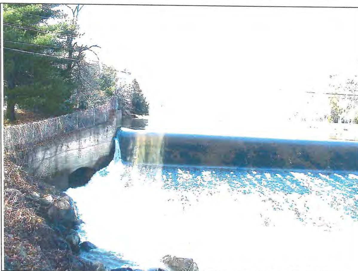
Photo # 5. Un film de particules fines provenant de la zone des travaux est visible sur la crête et le déversoir du barrage (à gauche sur la photo).
