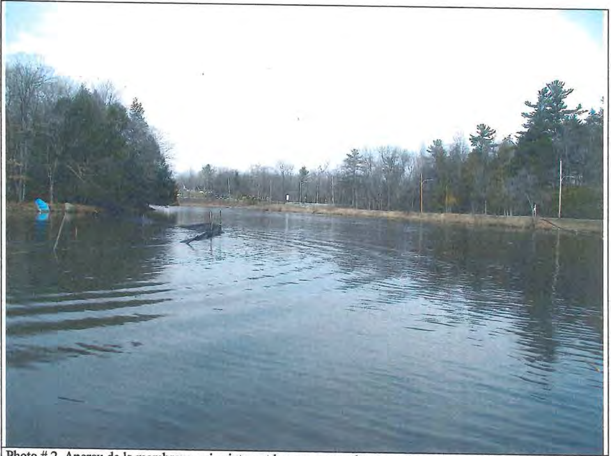
Photo # 2. Aperçu de la membrane qui ceinturent la zone amont des travaux ; vue de la rivière du Nord
