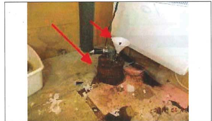
DSC04050 (Small).JPG Photo 8. Tête de puits rouillée et entonnoir pour eau de javel
