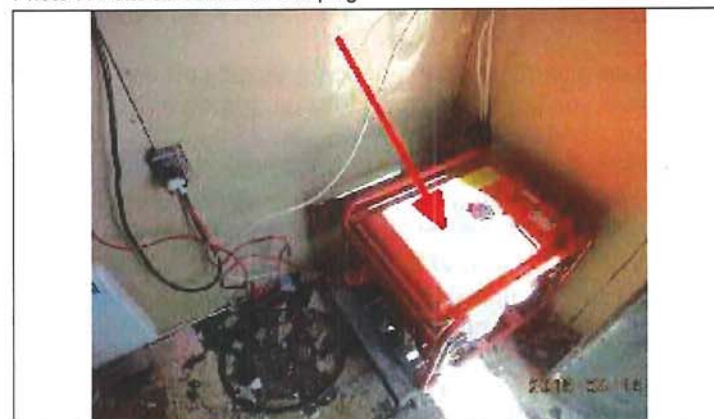
DSC04051 (Small).JPG Photo 9. Génératrice
