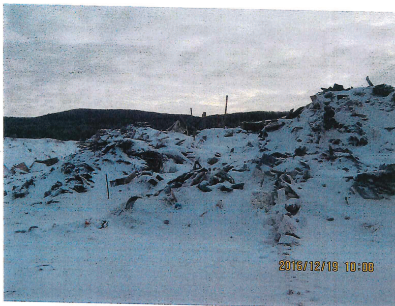
IMG_4128.JPG Débris de construction et démolition non triés sur le site.
