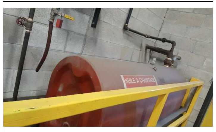
Réservoir d'huile à chauffage - 20180301_100908.jpg
