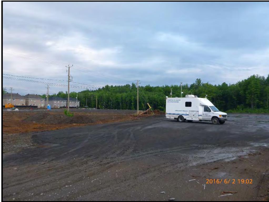
Photographie 17 : Station O, dans le nouveau développement résidentiel.
