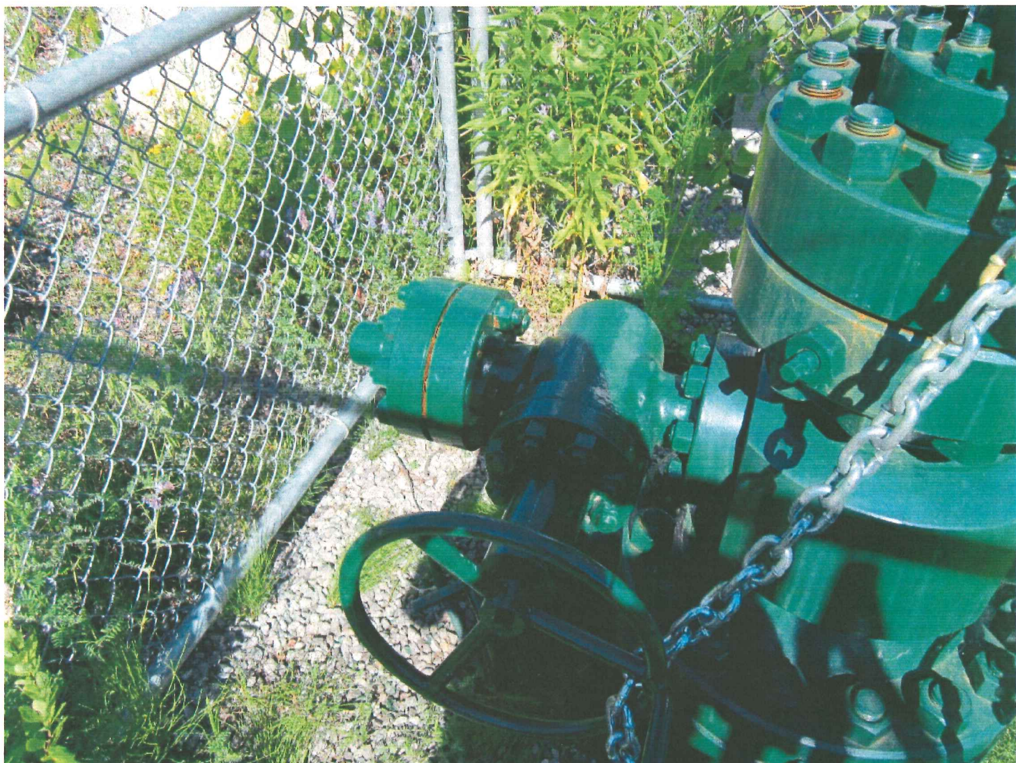
St-Louis 002.jpg Endroit où a été localisée la fuite
